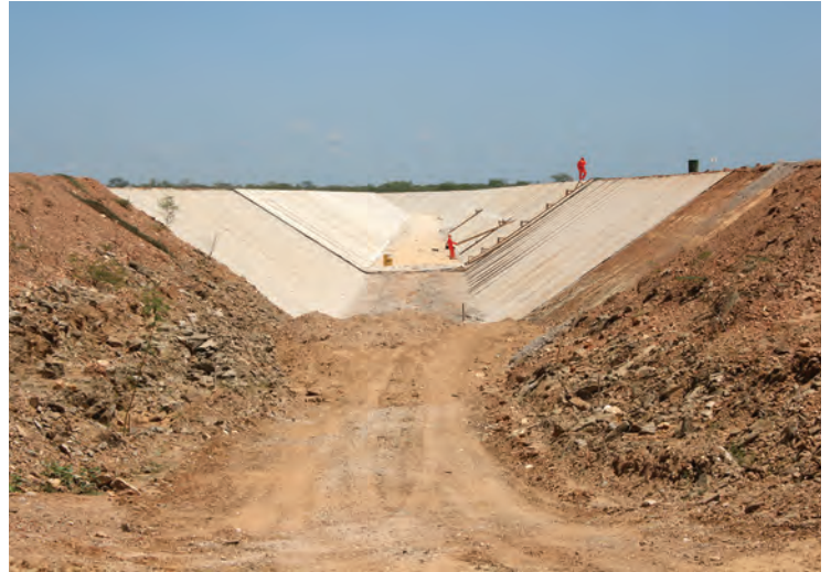
Fig. 8.6 Construção de canal do projeto de transposição de águas da bacia do rio São Francisco, no Nordeste do Brasil. O canal é escavado no solo e revestido de concreto, sendo um dos impactos evidentes a barreira à fauna, não claramente listado no Quadro 8.7
