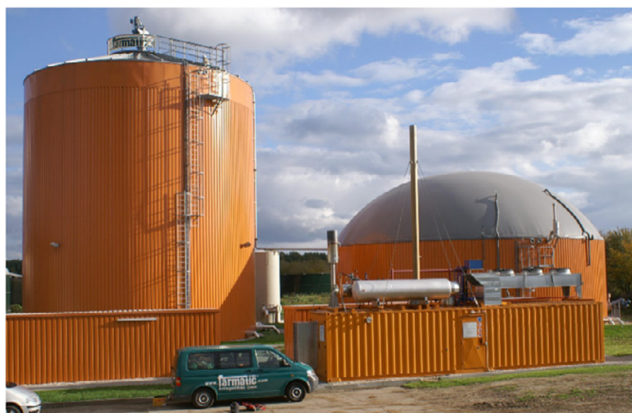
Figura 9: CSTR com misturador central e pós-digestor com armazenamento de biogás
