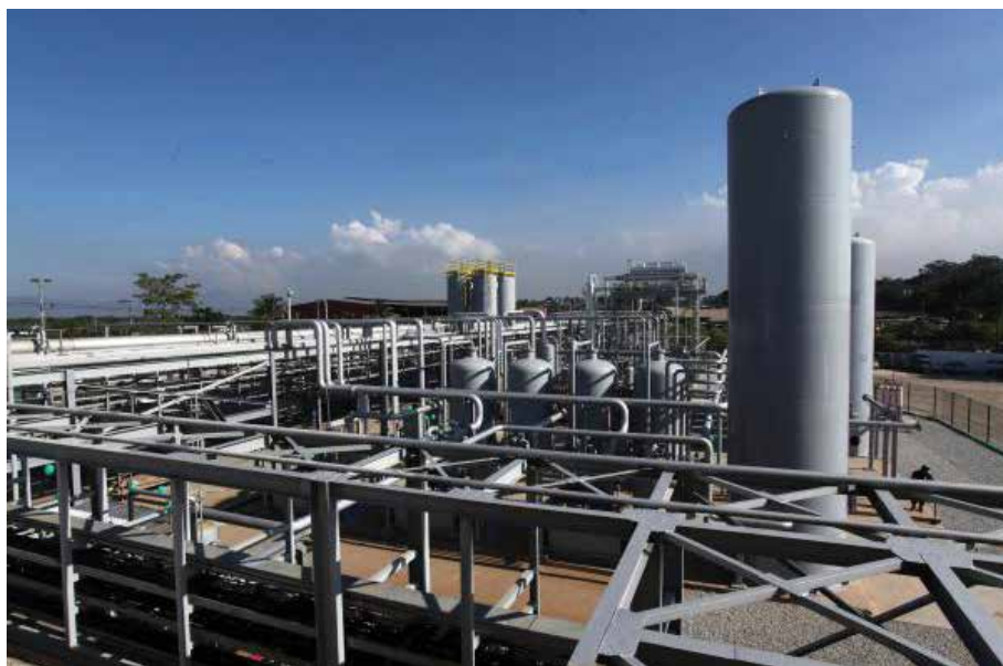
Figura 34 - Usina de biogás instalada no Aterro de Gramacho, RJ. Fonte: AIB News, 2013.
