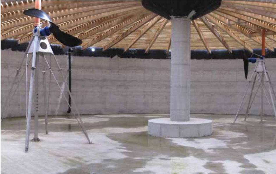
Figura 7 – Vista da parte interna de um reator CSTR com destaque para os agitadores submersíveis. Fonte: KSB, 2015.
