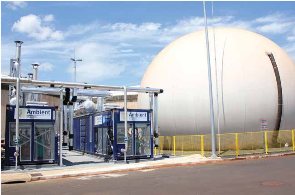
Figura 31 – Destaque para os grupos geradores instalados na ETE de Ribeirão Preto, SP. Fonte: GUASCOR, 2011.
