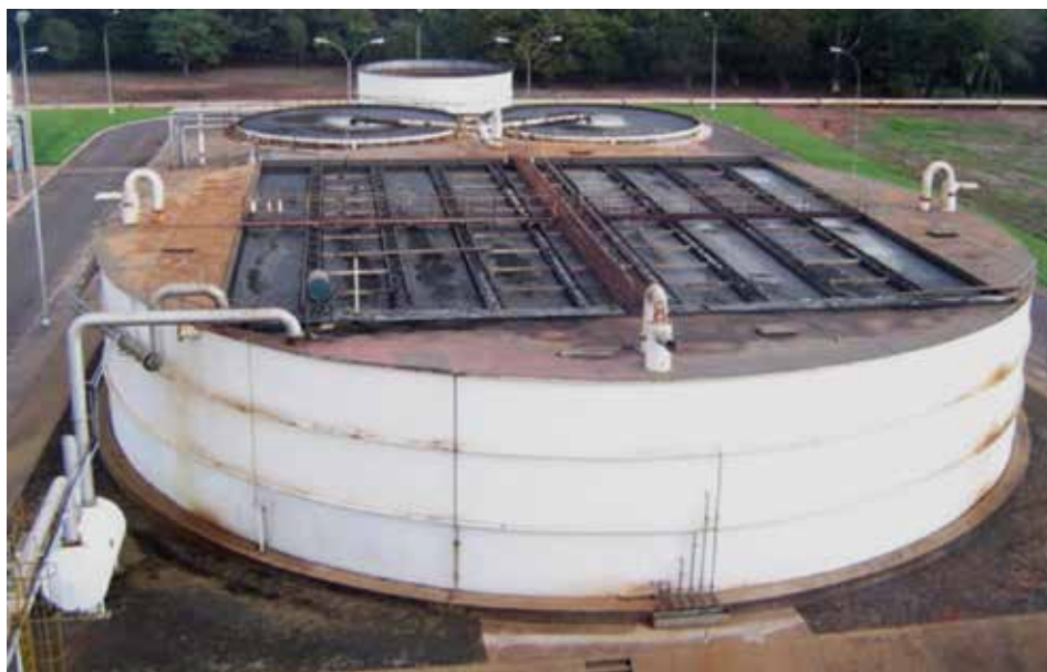
Figura 24 – Sistema de metanização de vinhaça instalado na Usina São Martinho, em Pradópolis, SP. Fonte: Silva, 2015.
